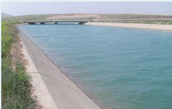
Resim 1. Güvenlik önlemi alınmamış dolu su kanalı-Şanlıurfa
