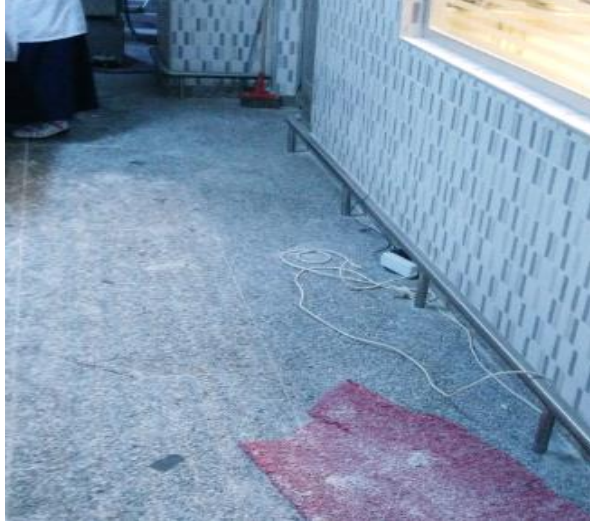
Resim 2.7. Elektrik kablolarının dağınık vaziyette bulunması
