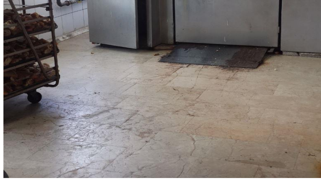
Resim 2.2. Hasarlı ve yıpranmış zemin
