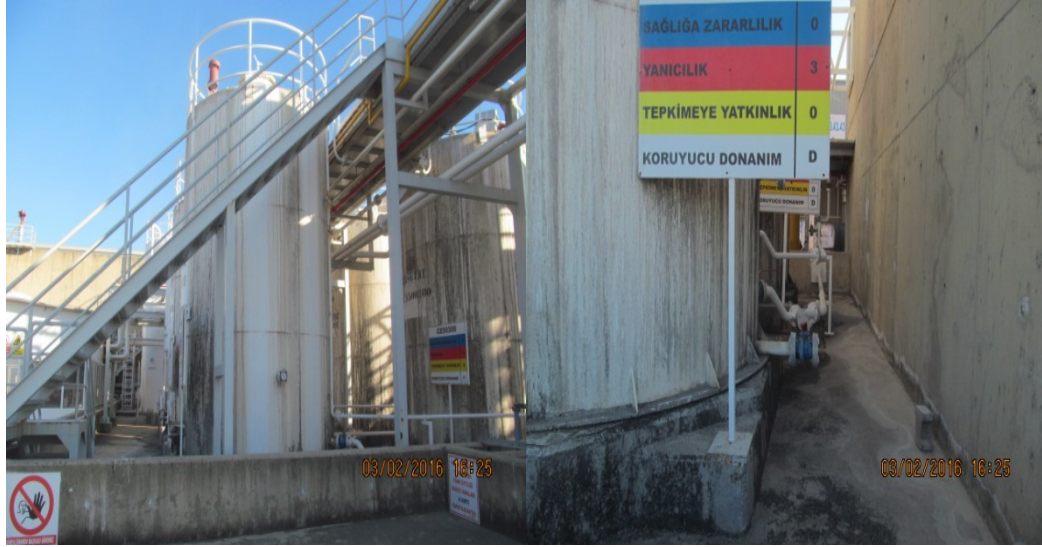
Resim 4.3. Yerüstü solvent tank sahası tesis fotoğrafı
