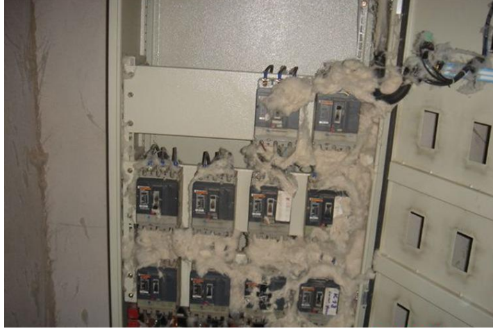
Resim 2.1. İçi hav dolmuş elektrik panosu [25]
