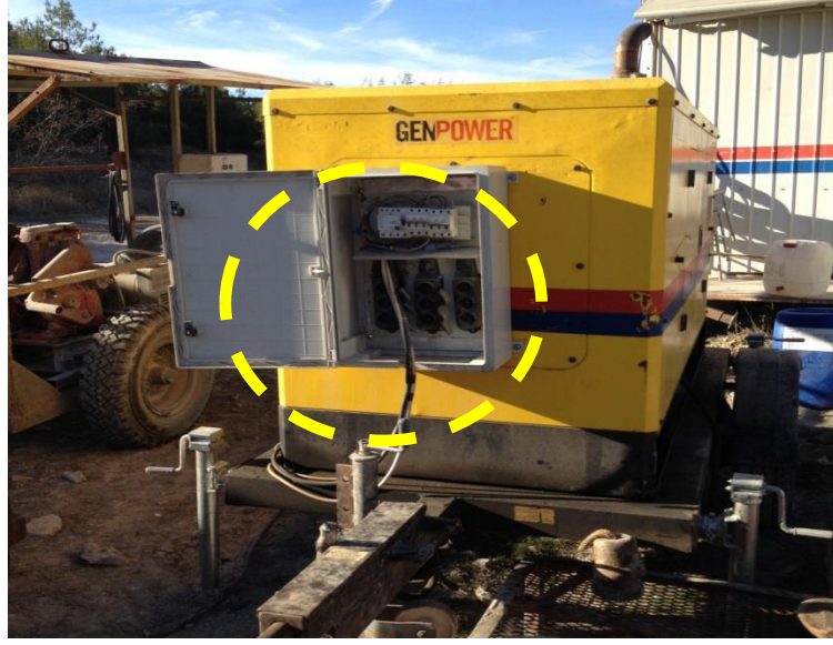
Resim 4.2. Uygunsuz elektrik panosu
