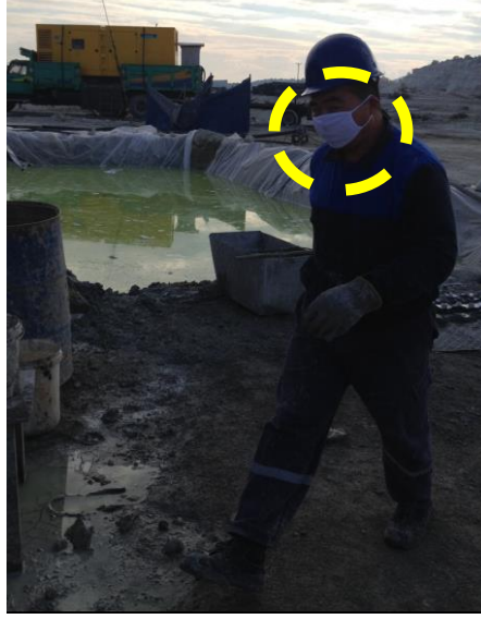
Resim 4.6. Uygunsuz kişisel koruyucu donanım kullanımı
