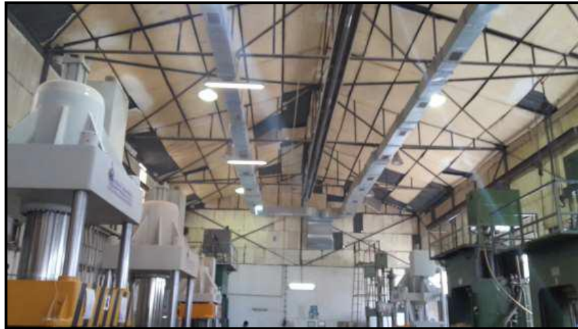
Resim 4.28. Preshanede aydınlatma kaynakları
