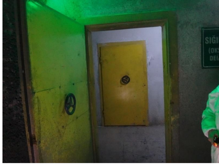
Şekil 4.19. İşletmede bulunan sabit sığınma odalarının kapısı
