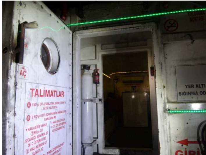
Şekil 4.20. Taşınabilir sığınma odasının kapısı
