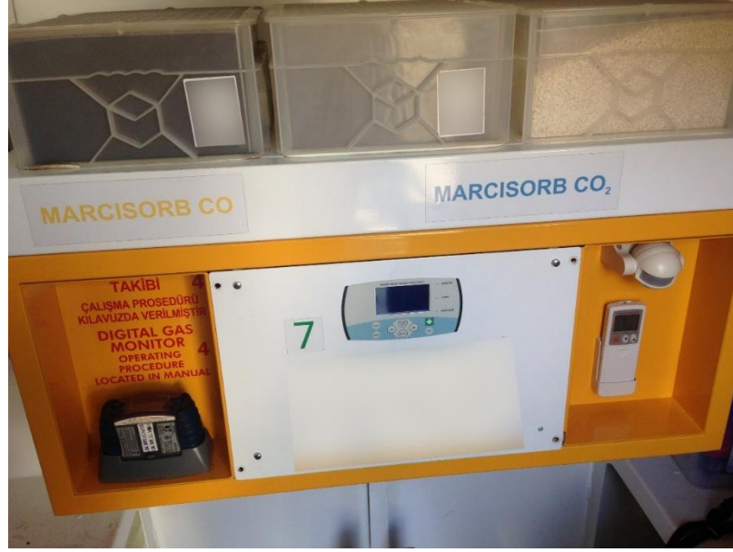
Şekil 4.11. CO 2 ve CO temizleyicisi
