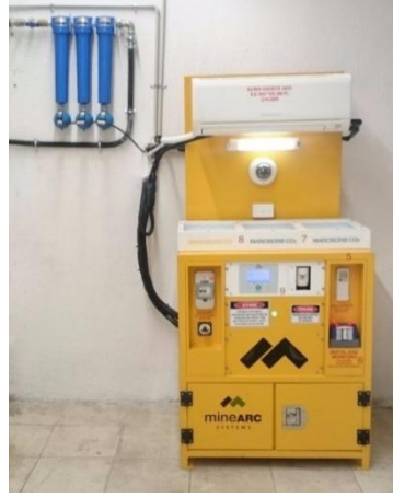
Şekil 4.29. Sabit sığınma odasında bulunan gaz temizleme ekipmanı
