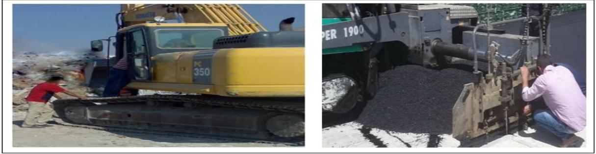
Resim 4.4. Bakım, Onarım, Temizlik Çalışmalarında KKD Kullanılmaması
