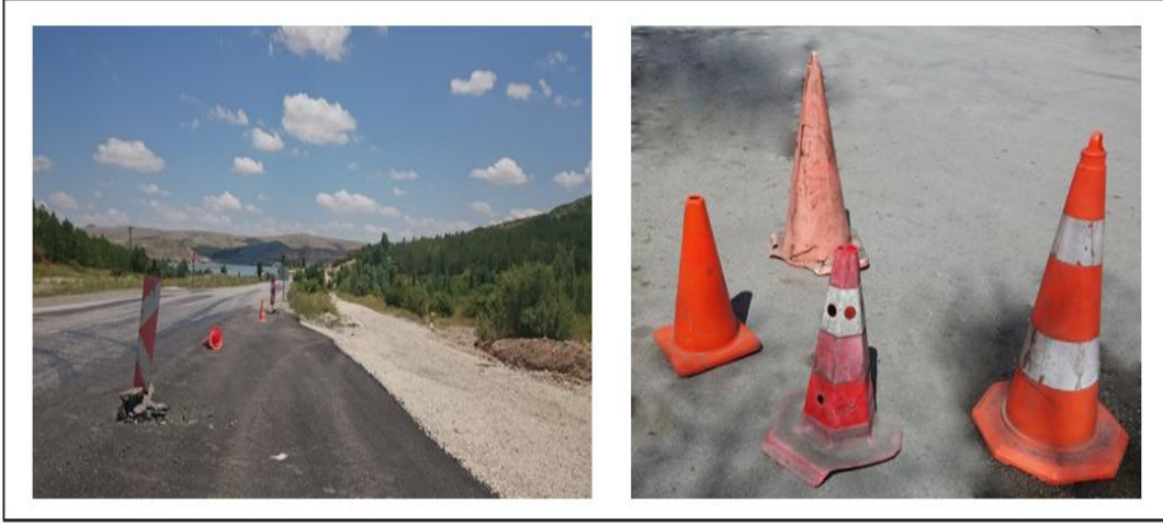
Resim 4.17. Uygun Olmayan Uyarıcı Ve Sınırlayıcı Ekipmanlar
