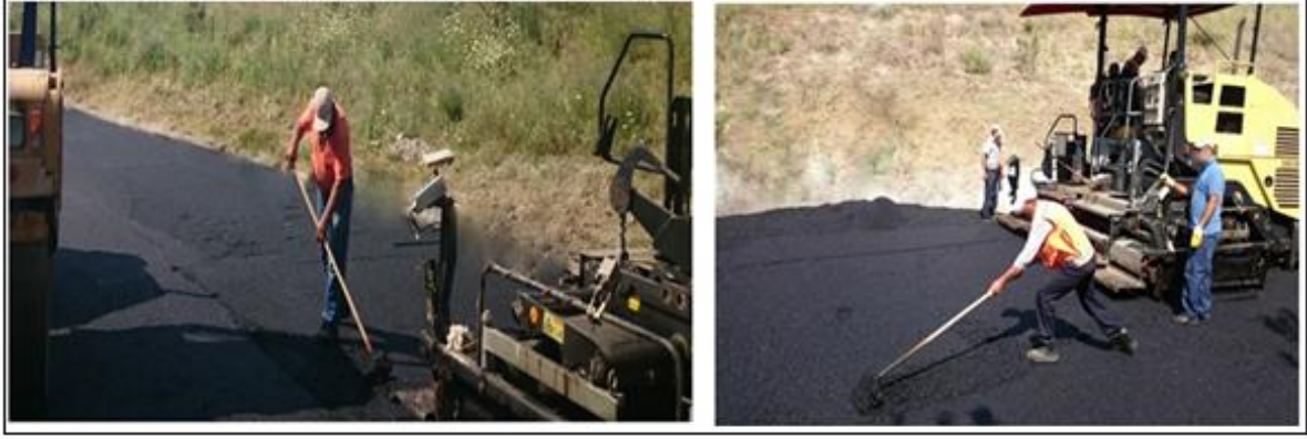
Resim 4.16. Koruyucu Ekipmanlar Olmadan Sıcak Alanlarda Çalışılması
