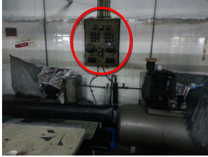
Resim 4.4. Otopark içinde uygunsuz elektrik panosu örneği
