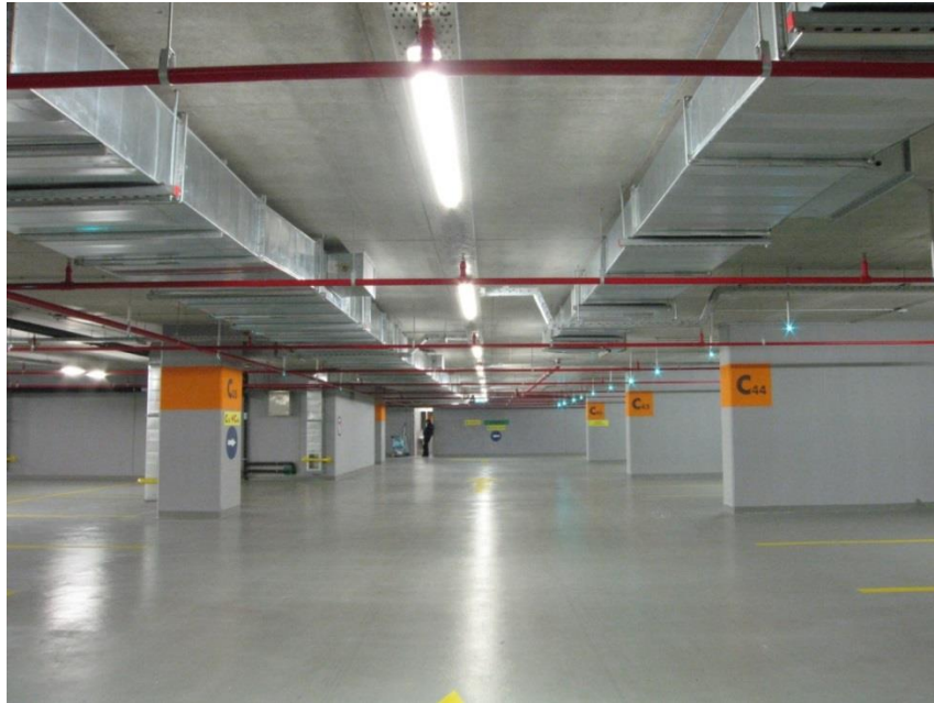
Resim 2.7. Otopark havalandırması - kanallı sistem [28]
