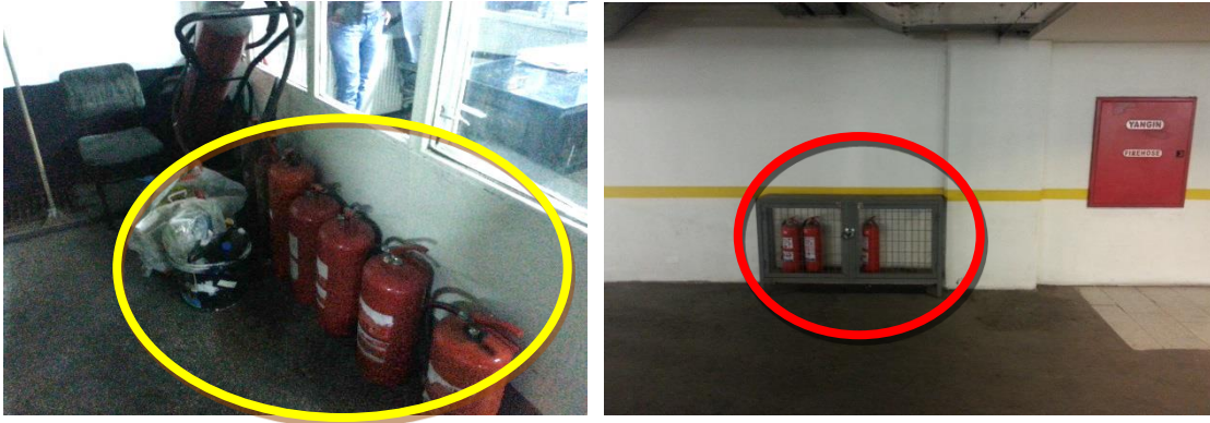
Resim 4.8. Uygun yerleştirilmeyen yangın söndürücü tüplere örnekler
