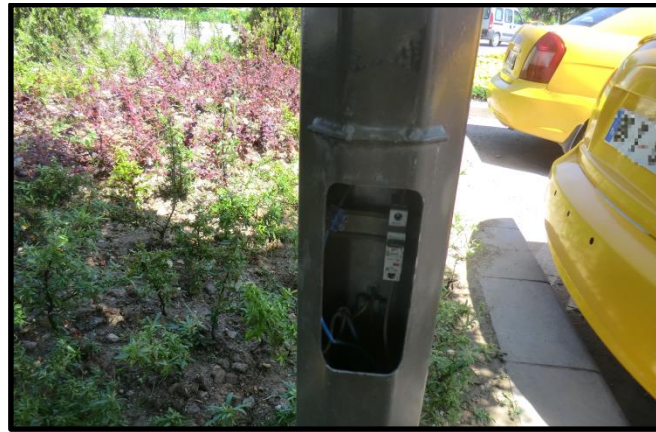
Resim 4.45. Kabloları açıkta duran elektrik direği
