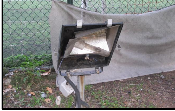
Resim 4.44. Hasarlı aydınlatma elemanı
