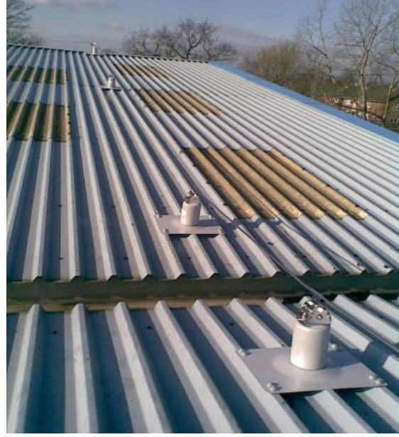
Çatılarda Yaşam Hatları
