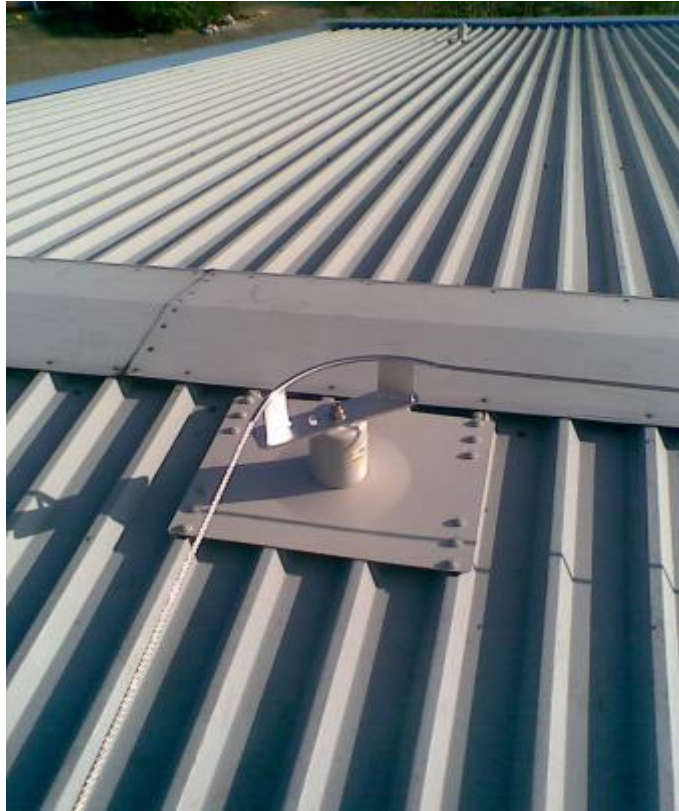
Çatılarda Yaşam Hatları
