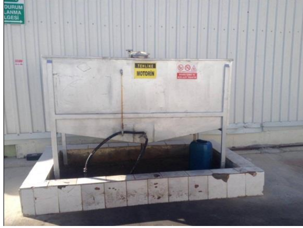
Resim 4.34. Motorin Tankının Kontrolsüz Şekilde Ulaşılabilir Olması
