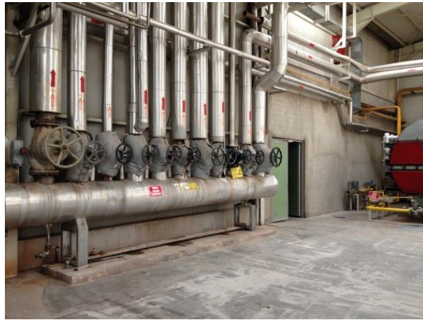
Resim 4.39. Kazanların Ve Buhar Kollektörlerinin Sıcak Yüzeyleri
