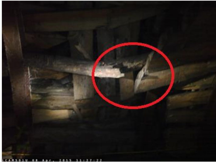
Resim 4.1. Çalışma Alanından Uygun Olmayan Tahkimat Örneği
